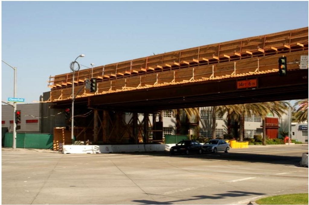
Travaux pour la future station de métro Olympic Station à Santa Monica – Photo Jean Leveugle
